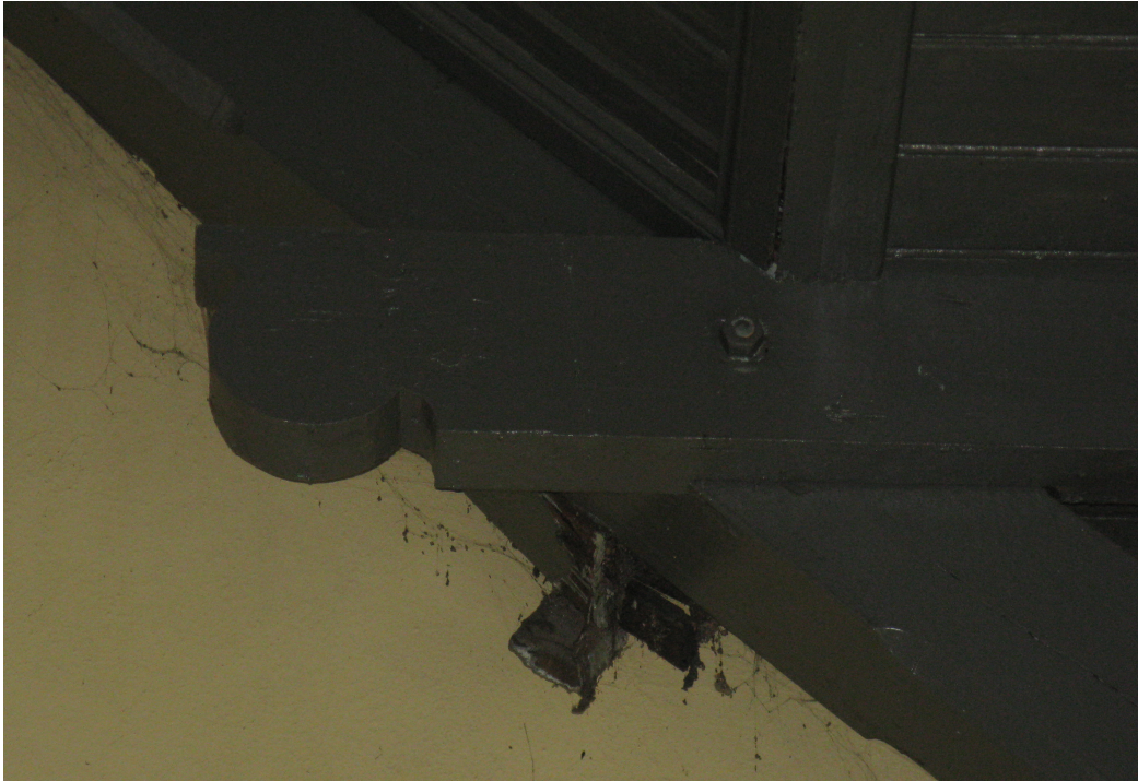
Zdjęcie nr 3 – Szczegół połączenia kleszczy
