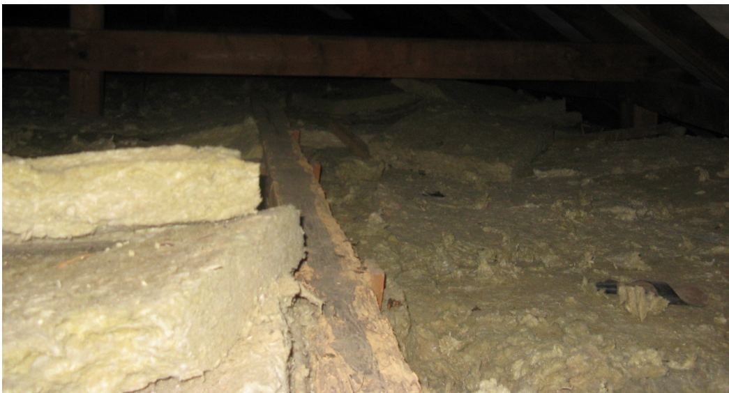
Zdjęcie nr 4 – Widok zniszczonej belki nośnej sufitu
