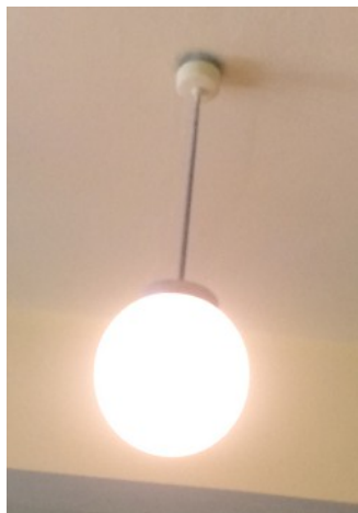
zdj. 2 Oprawa zwieszana na E27 100W na korytarzach
