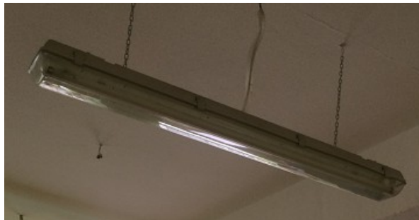
zdj. 1 Oprawy świetlówkowe na 2xT8 36 i 2x58W zamontowane w salach lekcyjnych
