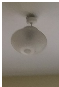
zdj. 3 Oprawa na kl. schodowych i zapleczach na E27 60W lub 75W
